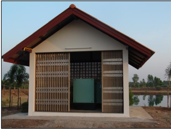
ก่อสร้างอาคารโรงสูบน้ำพร้อมระบบจ่ายน้ำ ๑ หลัง
