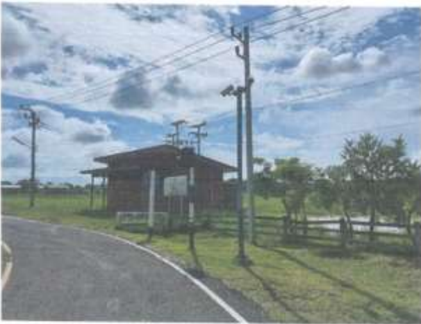
๕. บริเวณอาคารควบคุมพลังงาน จำนวน ๒ ตัว (ชำรุด ๒ ตัว)
